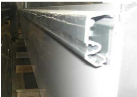
Рис. 1. Требуется замена отбойника
